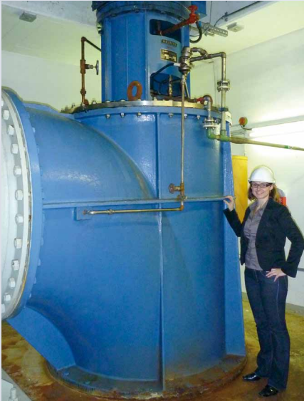
Hauptkühlwasserpumpe im Kraftwerk Rostock
