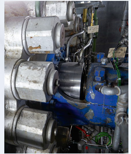
Weller-Kesselspeisewasserpumpe im Steinkohlekraftwerk in NRW
